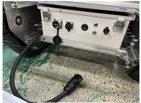
電装ボックス側
